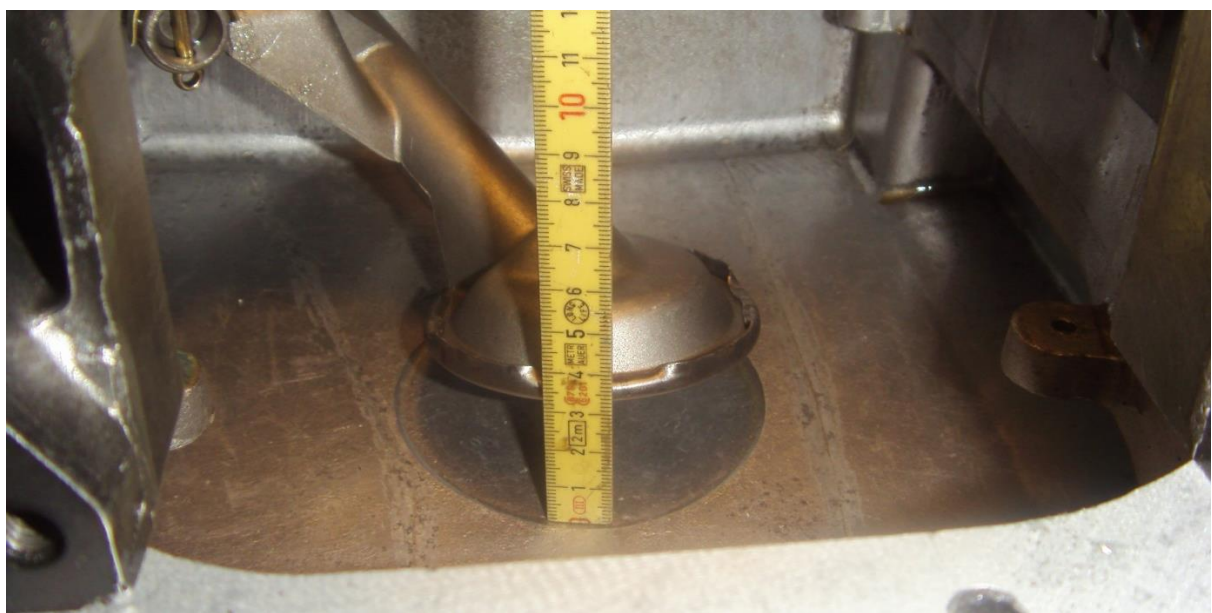
Aspect de la crépine de la pompe gros débit. La crépine est loin du fond et inclinée
